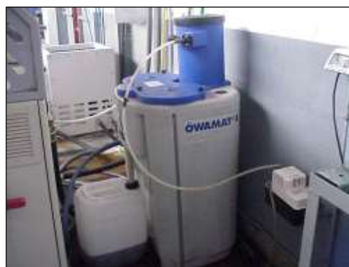
Equipo separador agua/aceite
