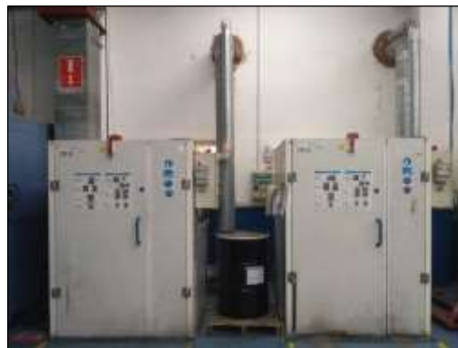
Cámara de curado por CO 2
