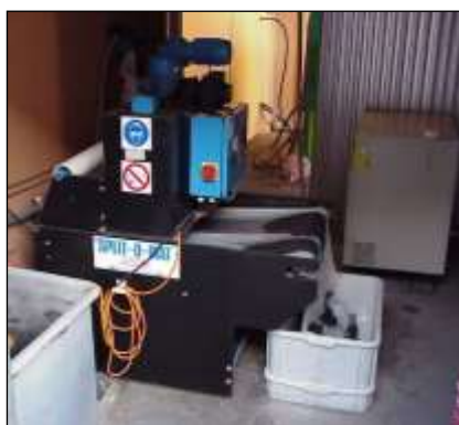
Depuradora por floculación
