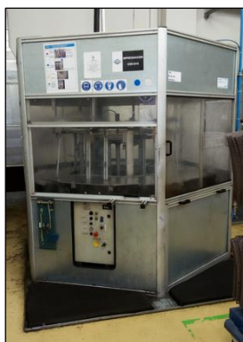
Cabina de impregnación
