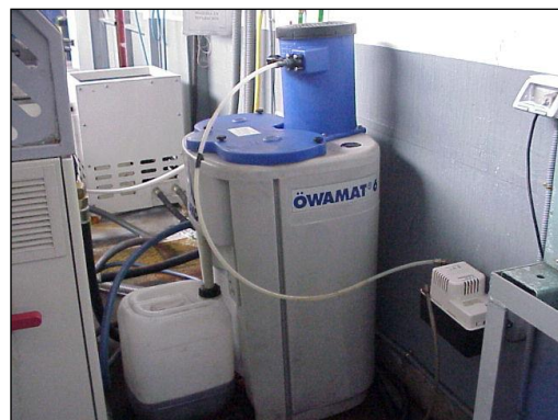
Equipo separador agua/aceite
