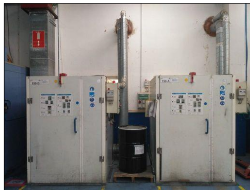
Cámara de curado por CO 2
